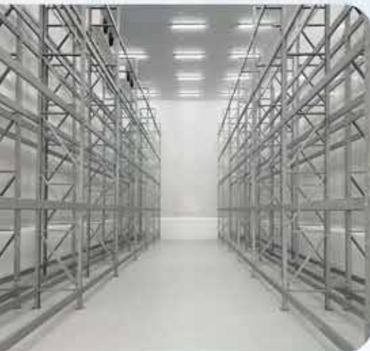
Cámaras industriales frigoríficas
