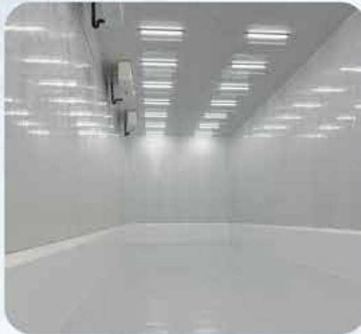
Cámaras industriales frigoríficas
