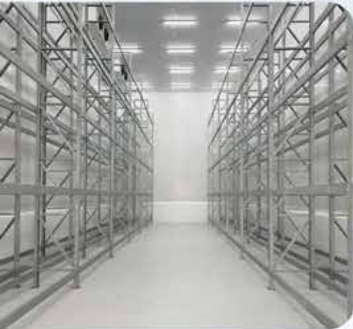
Cámaras industriales frigoríficas
