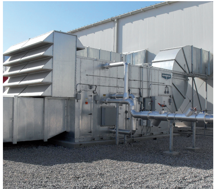
La ventilación general, consiste en la renovación del aire contaminado de los interiores de las naves al mismo tiempo que se aporta aire limpio del exterior
