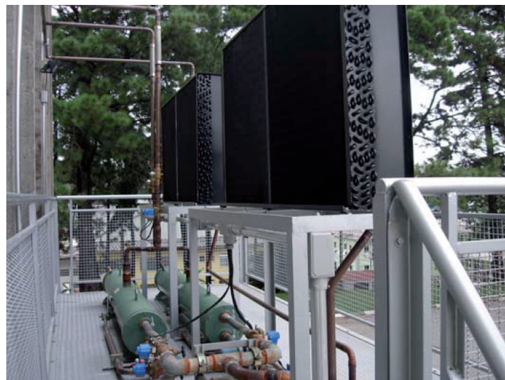
Figura 07: Detalle de los condensadores resfriados por agua y por aire.
