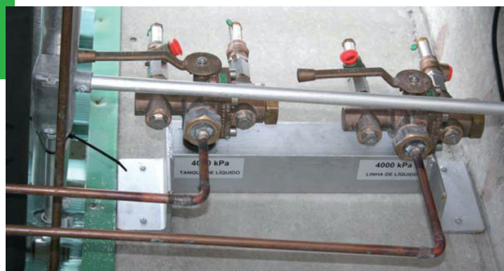
Figura 14: Detalle de las válvulas de alivio de presión instaladas en la parte externa.
