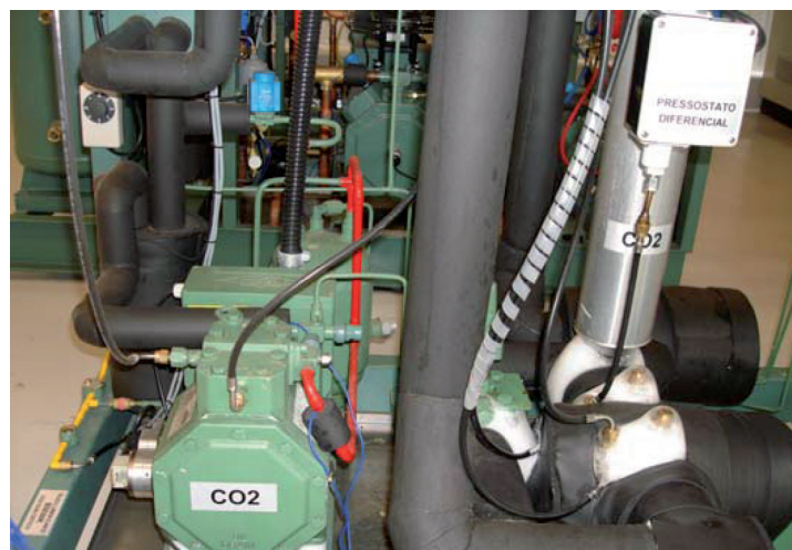
Figura 05: Detalle del compresor CO2.
