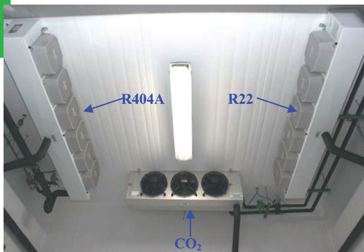
Figura 03: Detalle de los evaporadores instalados en las cámaras de congelados y enfriados.
